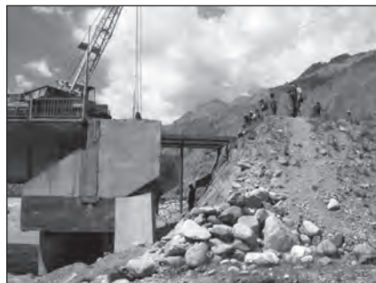
Рис. 170. Мост через Иныльчек, размытый летним паводком, 27 июля 2006 г.
